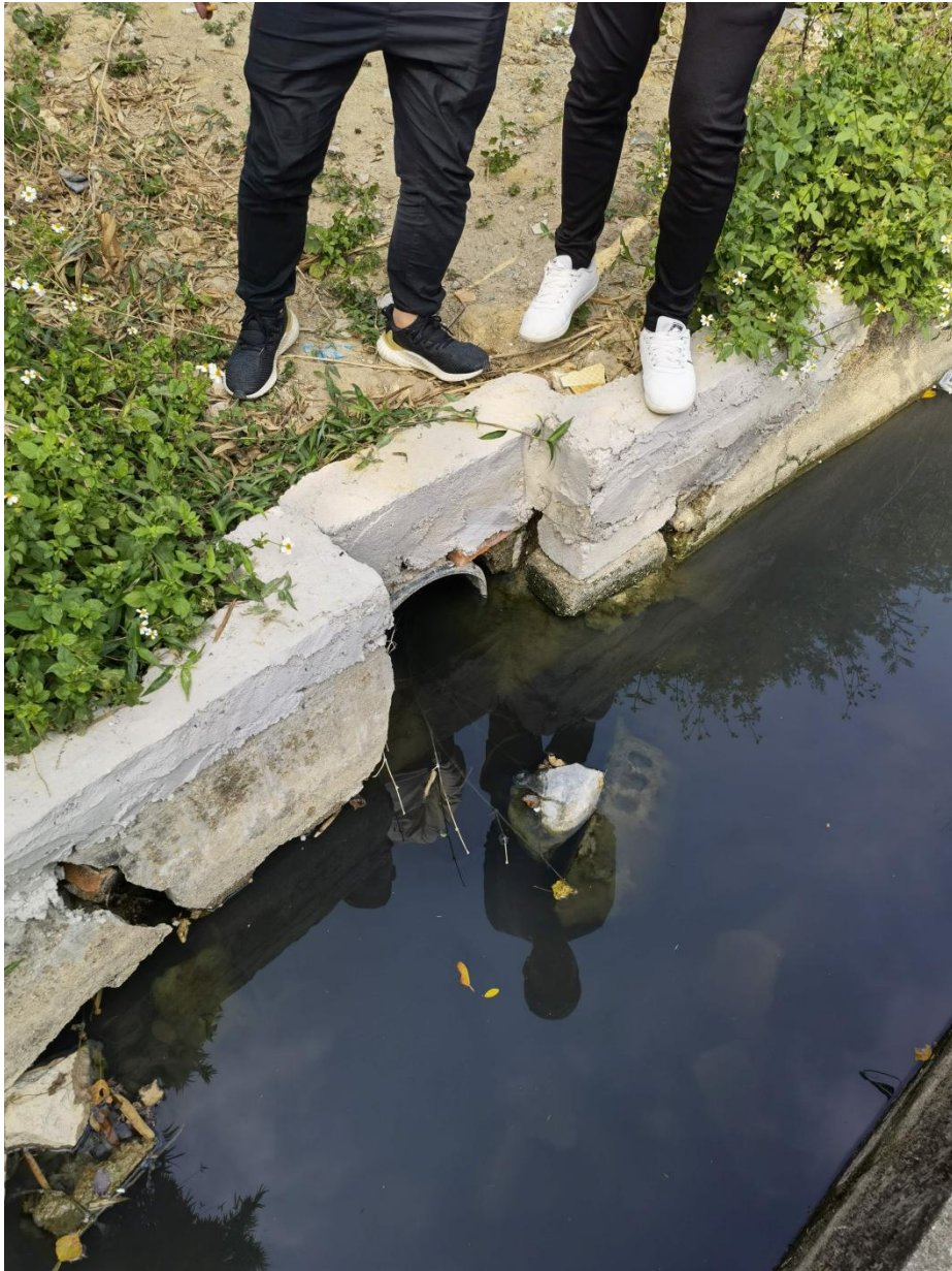
图 3.3-2 新屯寮小三格+大三格处理排污口出水现状照片
