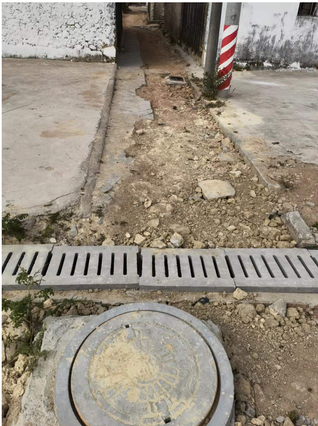
图 3.6-2 新屯村等部分村庄管网未硬化
